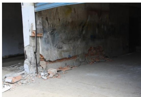
Figure 2: Dégradation d'un poteau et d'un mur de cloison suite à un soulèvement de cette structure à Azazga 2012.
