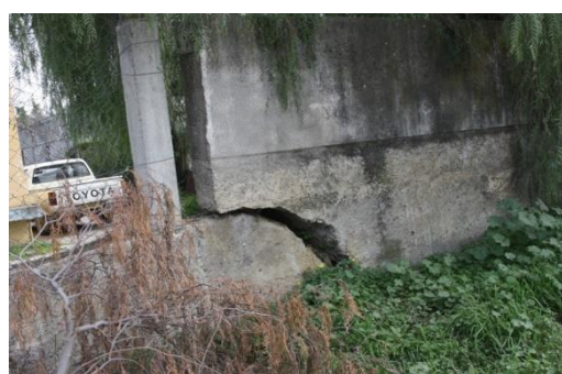
Figure 4 : Fissuration d'un mur de clôture à Tizirt en 2014.
