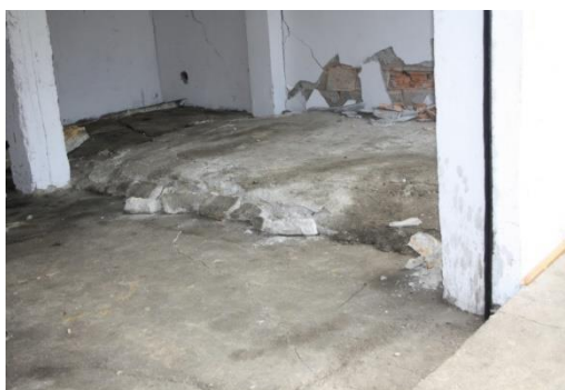
Figure 1 : Soulèvement de la dalle d'une maison à Azazga en 2012
