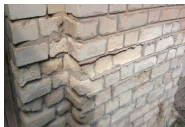
Figure 3 : Dégradations résultant du ruissellement, prototype bioclimatique
