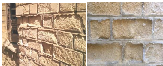
Figure 4 : Alvéolisation des blocs en façade
